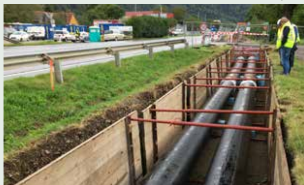
Foto: Bioenergie Fernwärme/Mag. Jakob Edler
